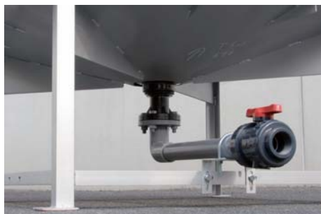
タンク底部の傾斜により残液を残さない構造になっています。
